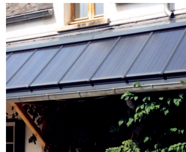
Les capteurs sont utilisés comme auvent. Orientés nécessairement au sud, ils seront également efficaces comme protection solaire.
