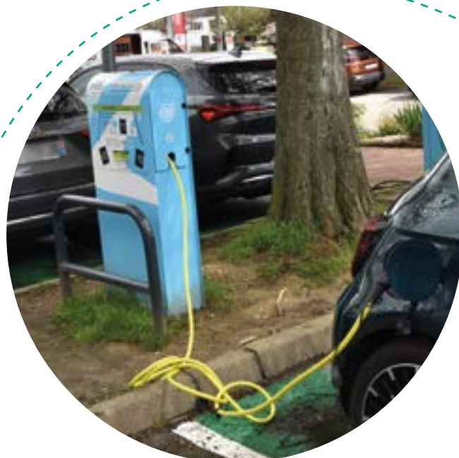
BORNES ÉLECTRIQUES Des bornes électriques pour le rechargement des véhicules électriques des particuliers ont été implantées sur la voie publique, au centre-ville et aux Bessières.
