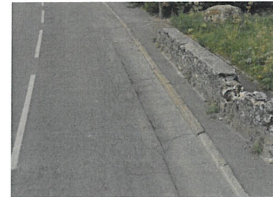
Désordres rue de Coignères
